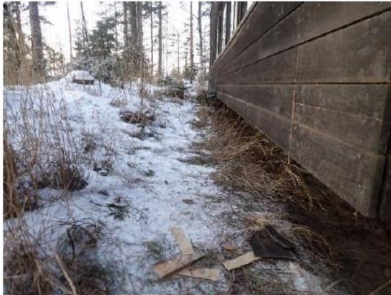
Kuva 1. Rakennuksen länsisivua. Vierustalla on kasvillisuutta, joka ulottuu paikoin ulkoseinään. Maanpinta viettää lievästi rakennusta kohti.
