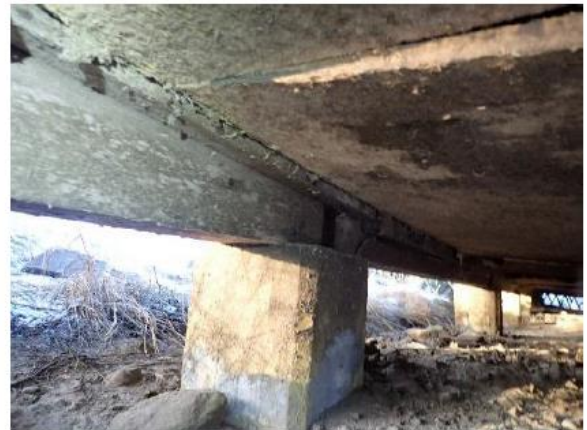
Kuva 4. Rakennuksen vierellä länsisivulla maanpinnassa on painauma, joka ei selkeästi vietä hulevesiä rakennuksen ohi. Kuvassa on näkyvissä myös kosteus- ja mikrobivaurioitunutta alapohjarakennetta.
