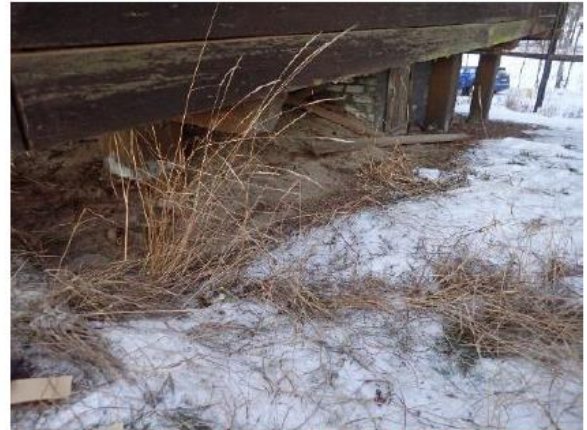
Kuva 2. Myös rakennuksen eteläpäädyssä on paikoin kasvillisuutta lähellä rakennusta. Maanpinta viettää kohti järveä.
