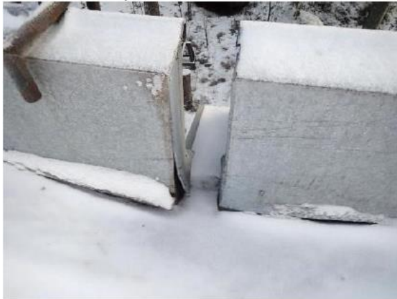
Kuva 7. Rakennuksen eteläpäädyssä sijaitseva sadevesikouru "ulosheittäjä". Kourussa on lunta ja jäätä ja kourun liitos räystäään reunakorotukseen on epätiivis.
